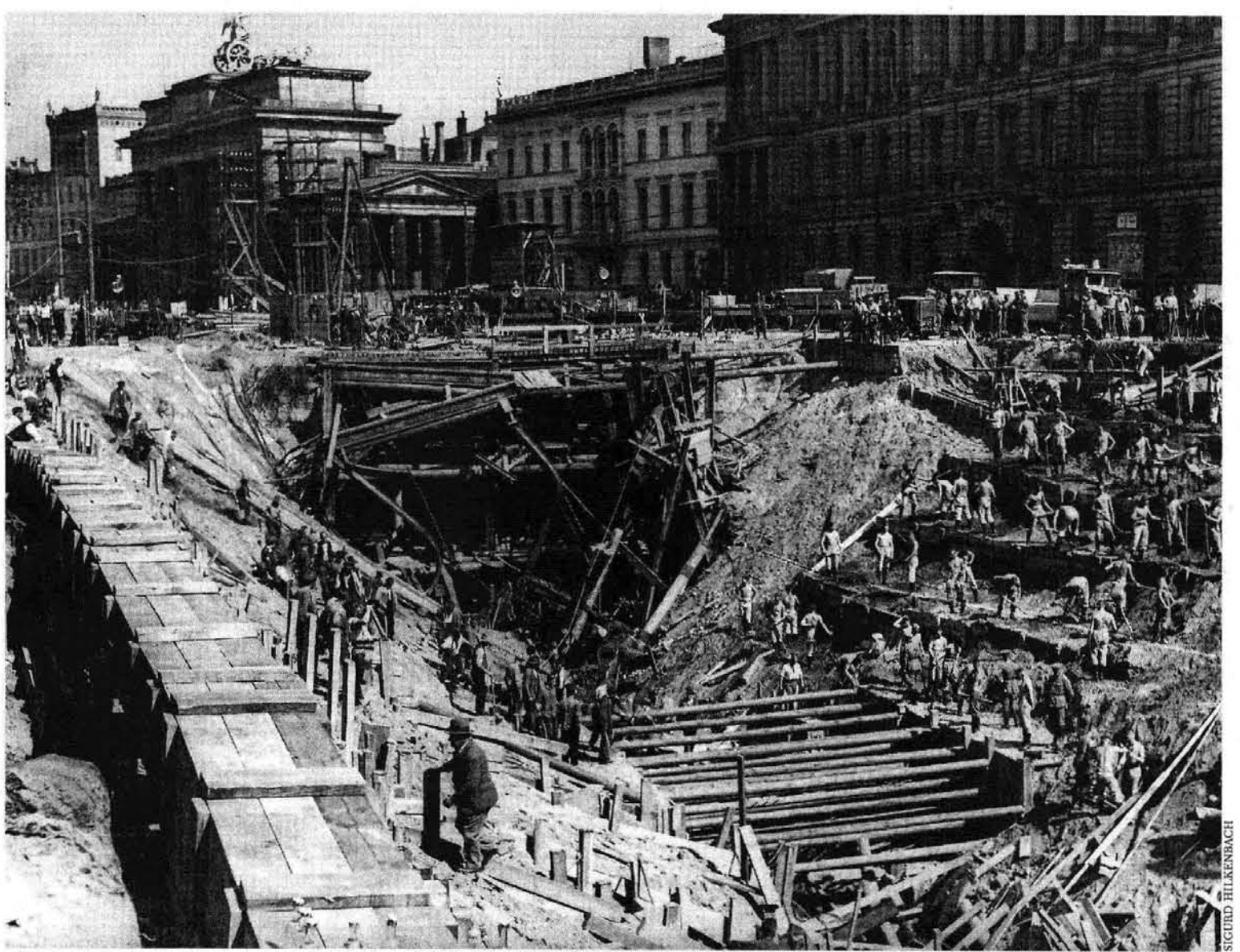
Aufräumarbeiten: Südlich des Brandenburger Tores brach am 20. August 1935 bei den Arbeiten zum Bau des Nord-Süd-Tunnels ein Teil der Baugrube ein
